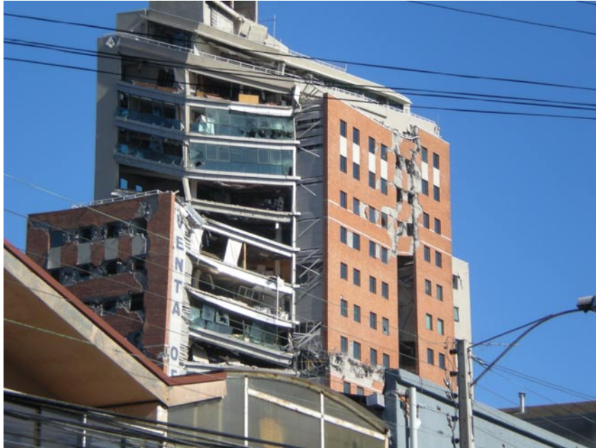
Edificio que simbolizó el sismo en Concepción. Departamentos en venta...
